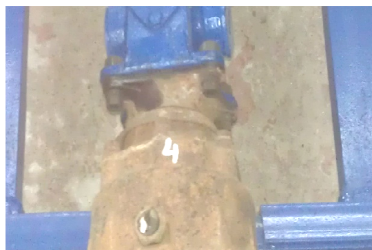
Рис. 5. Место установки вибродатчика на корпусе механизма блокировки
